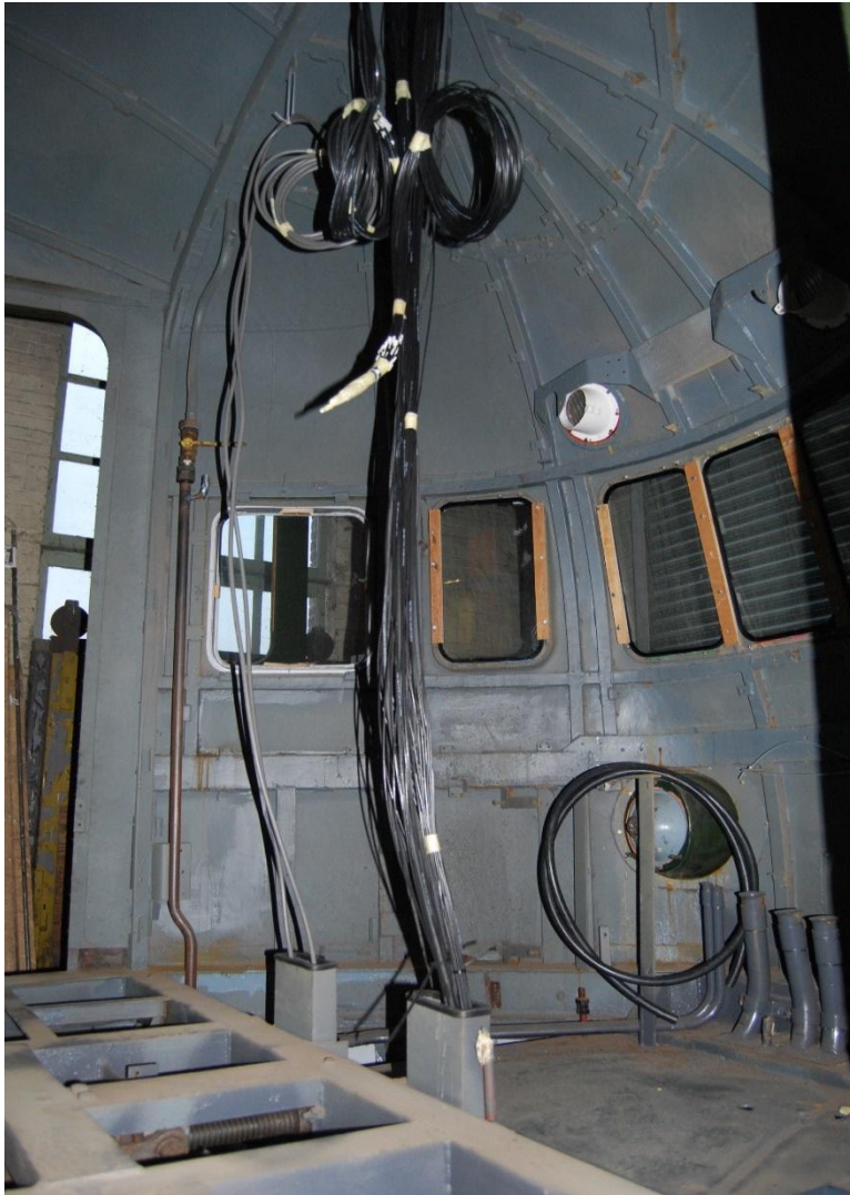
Een enorme bos kabels in één van machinistencabines.
